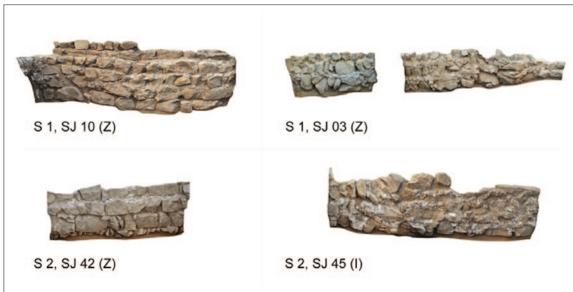
Sl. 3 Lica zidova SJ 003 i 010 u S 1 te SJ 042 i 045 u S 2 (nije u mjerilu) (snimili i obradili: K. Rabięga, R. Solecki, A. Konestra)
