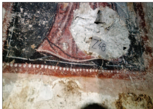
Sl. 12 Dubrovnik, podzemlje katedrale. Detalj zidne slike iz južne lađe; nepravilan i nedovršen donji rub žbuke nanese na prethodni sloj (dokumentacija projekta)
